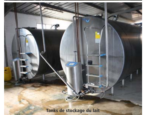
Equipements de refroidissement du lait
